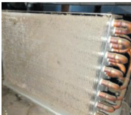
● 洗浄を提案された熱交換器
