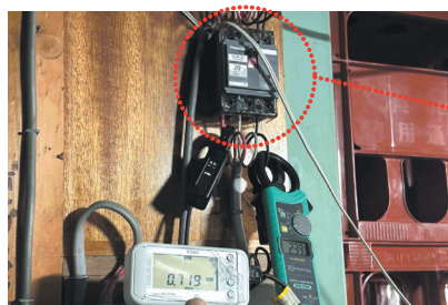
洗瓶機ポンプ ブレーカー
